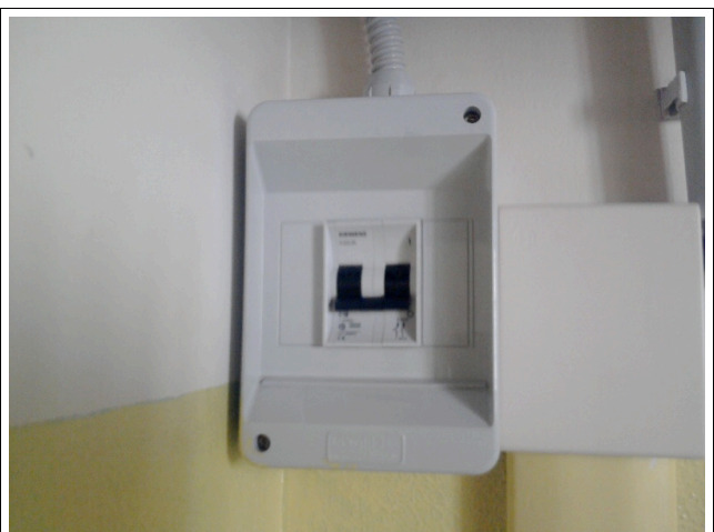
Interruttore generale all'interno. Spostare verso l'alto per attivarlo
